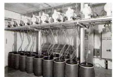
Abb. 6: Chemikalien-Dosieranlage MPS Thies für bis zu 25 Produkte (Foto: R. Seitz).
