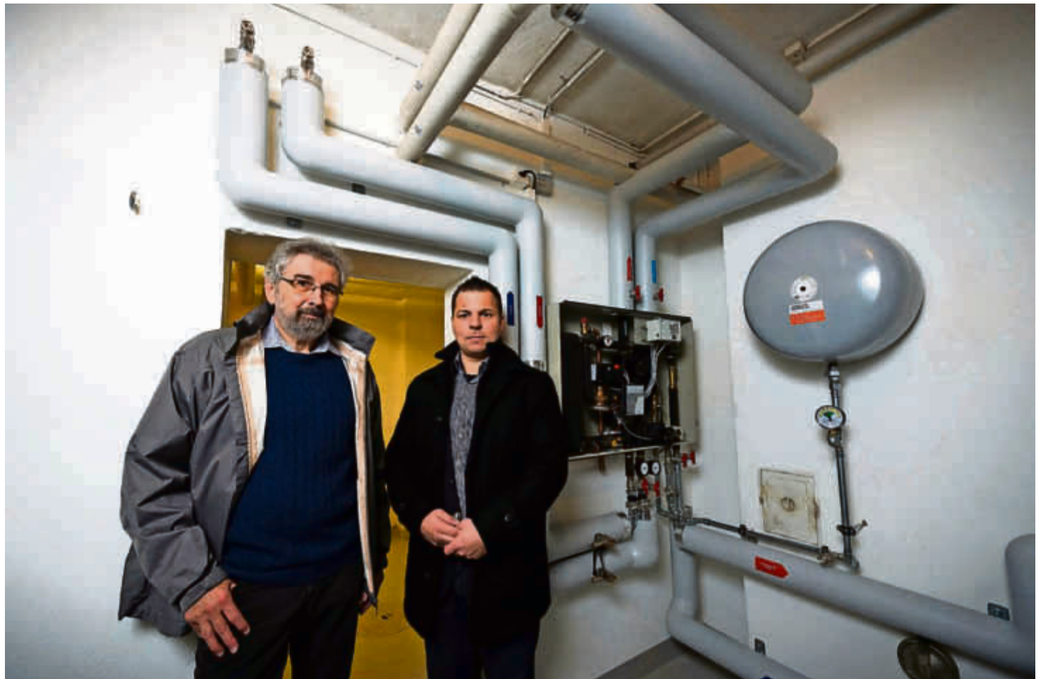
Max Gysin (links) hat das «gelbe Ungetüm» im Heizungskeller ersetzt. Urs Schellenberg beliefert das Pfarrhaus nun mit Abwärme.
